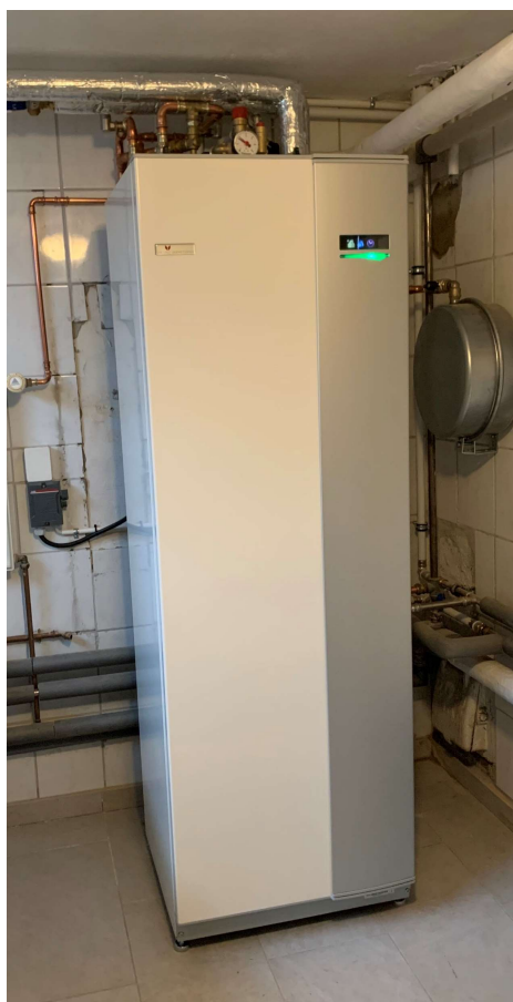
Indedelen, som indeholder varmtvandsbeholder og buffertank samt styring.
