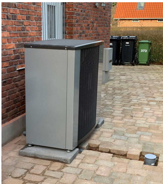
Udedelen, som er selve varmepumpen med kondensator, kompressor og blæser. Foran ses afkølb for kondens.
